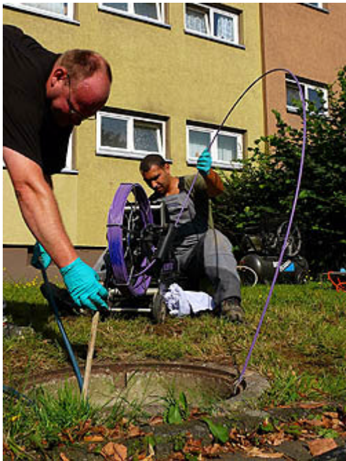
TV-Inspektion einer Grundstücksentwässerungsleitung. Nach dem neuen Wasserhaushaltsgesetz gehört dies künftig zu den Betreiberpflichten jedes Grundstückseigentümers in Deutschland - ebenso wie die Sanierung im Schadenfalle.
